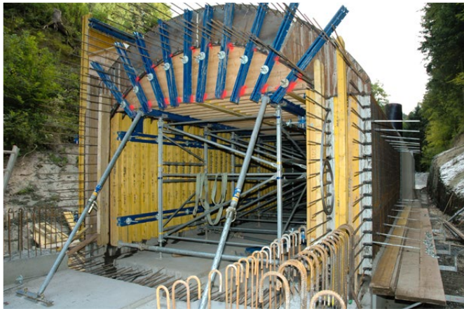
Top-Form dans un tunnel
