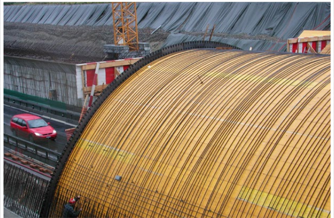
Top-Form dans un tunnel
