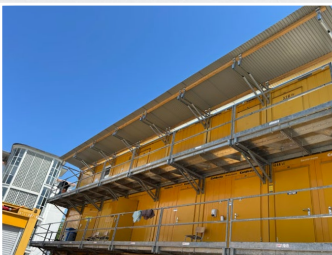
Avant-toits protégeant contre la neige avec le module Air-Step, toit
