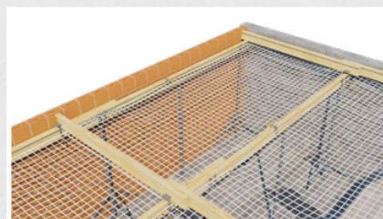
Le système Spider-Net est déjà installé et le coffrage par le haut peut commencer
