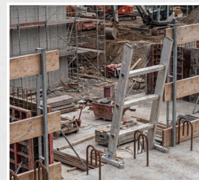
... ou dans des capsules de réservation MBT bétonnées
