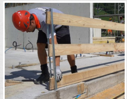
Mit dem MBT Steckpfosten lässt sich anschliessend spielend ein sicheren Seitenschutz nach EN 13374 erstellen
