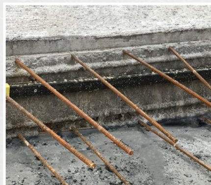
AES mit montiertem Injektionskanal
