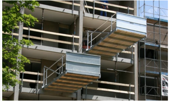
MS-Plattform auf unterschiedlichen Etagen
